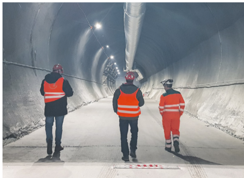
La centrale di Nant de Drance è sepolta nella montagna, costellata di gallerie. Un vero e proprio labirinto.
