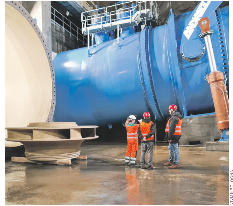
La visita termina di fronte a uno dei tubi di 7 metri di diametro che permettono di collegare i laghi di Emosson e di Vieux-Emosson.
