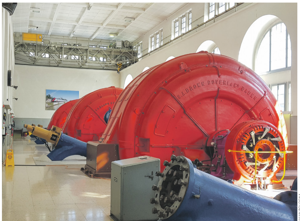
Nella centrale di Châtelard, le turbine da quasi 100 anni collegano la rete elettrica a 16,7 Hz delle FFS.
