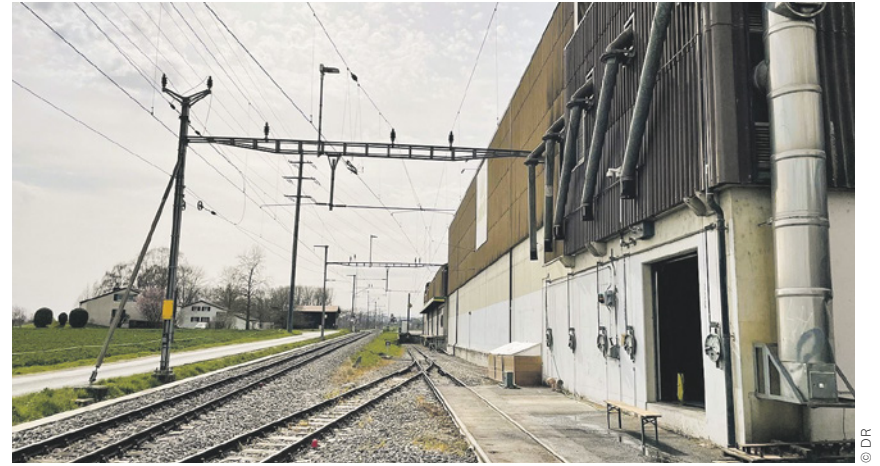
La zona di carico dei vagoni di Bussy-Chardonney che non rispetta le misure di sicurezza richieste
