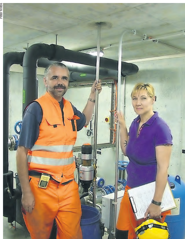
Rolf Allenbach et Evelin Schmid contrôlent une station de pompage.
